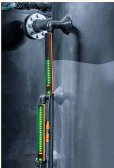
2. ábra Alkalmazás bypass csöveken
